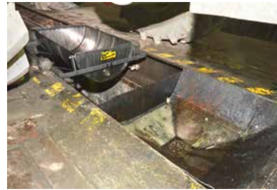
Praktisch: Schieb- und drehbare Auffangwanne für Öl sowie Entsorgungstrichter in der Grube.
